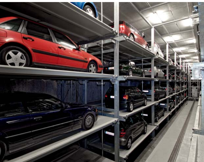
Vista interna dell'impianto di parcheggio automatizzato. Le auto vengono movimentate a motore spento.
